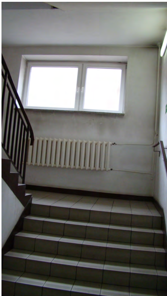
Widok klatki schodowej od środka, widoczny na zdjęciu grzejnik przewieszony zostanie na ścianę po lewej stronie, pod poręczą.
